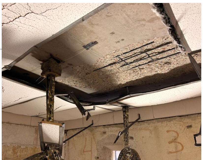
Schäden an der Rohbetondecke – sobald das Feuer durchschlagen kann (Bild ca. Minute 120).
